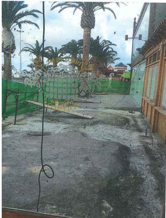
Foto 2. Estado previo a la ampliación no autorizada realizada recientemente
